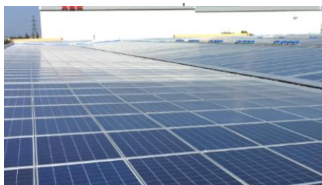
光伏一体化屋面
